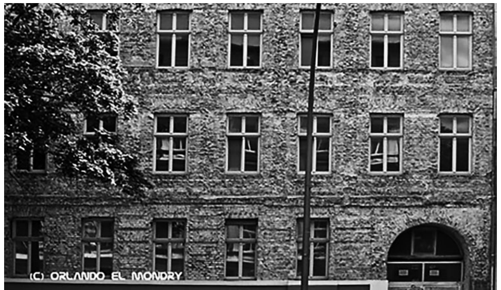
Die Perleberger Str. 50 mit abgeschlagenem Putz, aber nie saniert
